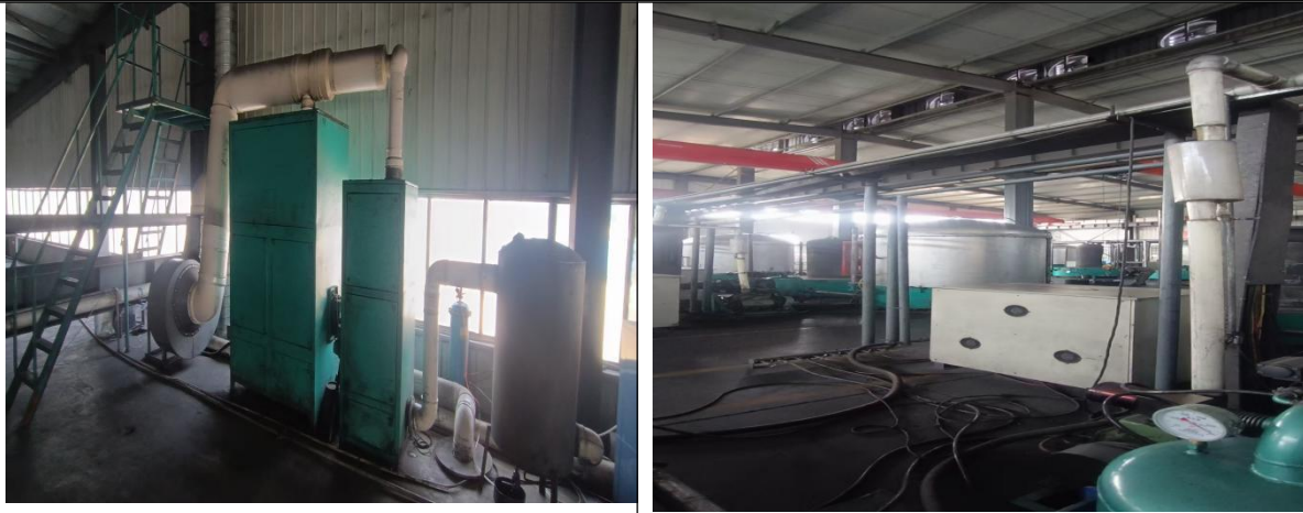
尾气治理设施
