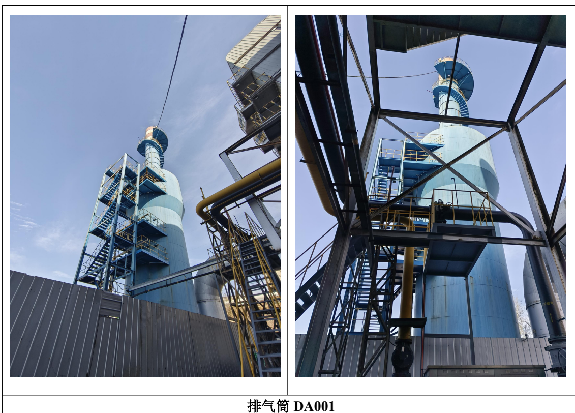
图 4.2-3 排气筒环保处理设施照片
