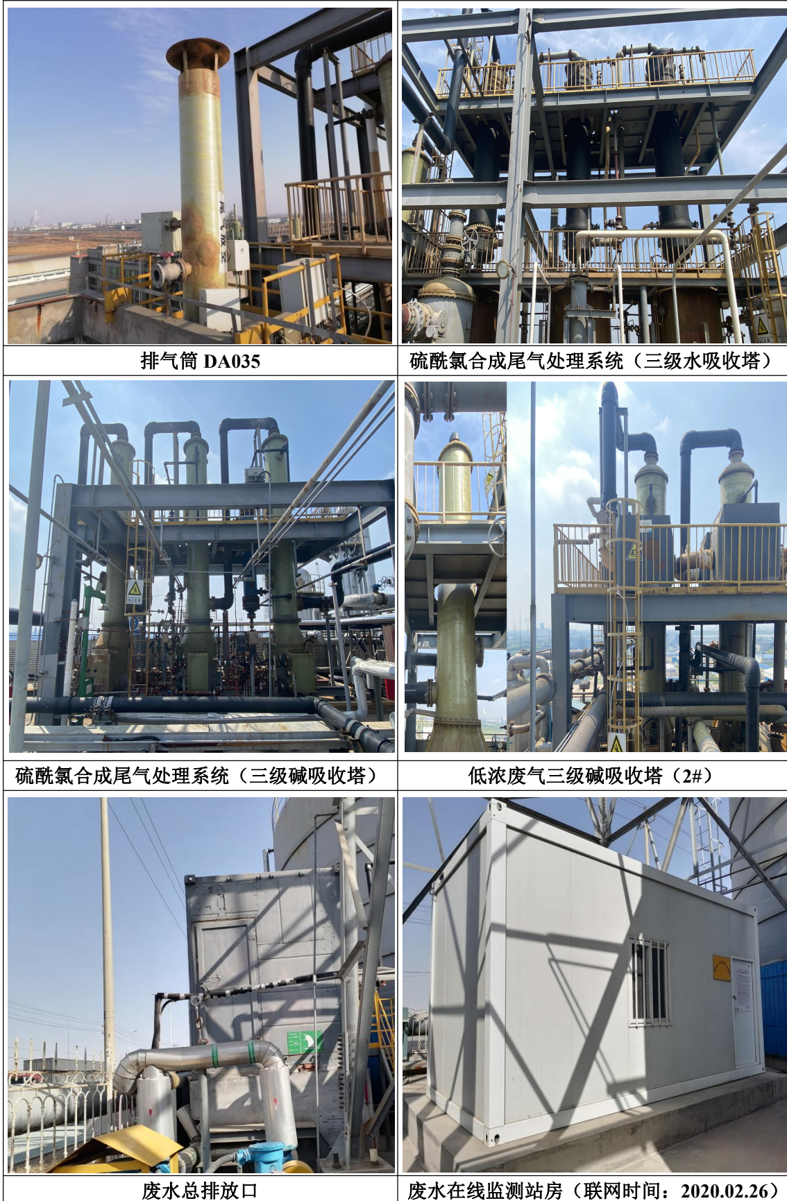
图 4.2-2 排气筒环保处理设施及废水总排放口照片
